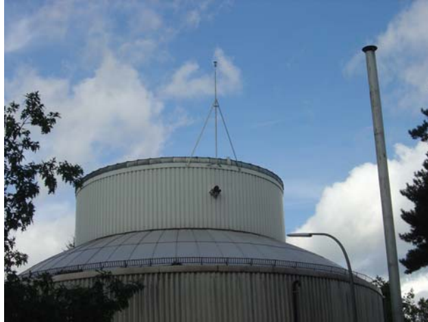
Abbildung 3.14: Ansaugvorrichtung für das Aerosol auf dem Dach der AIDA
